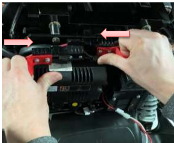
Figure 19 : Branchement des accumulateurs
